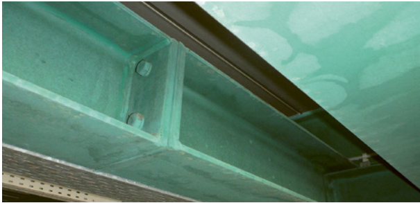
Vernici contenenti amianto
