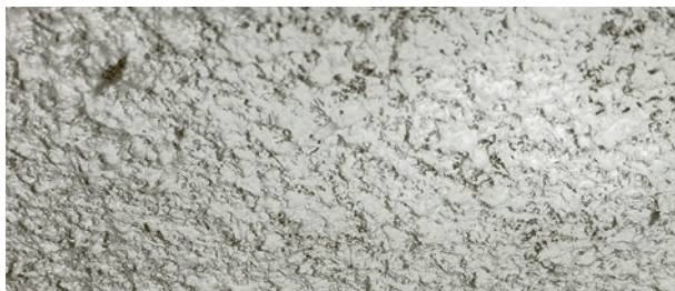
Intonaco acustico contenente amianto
