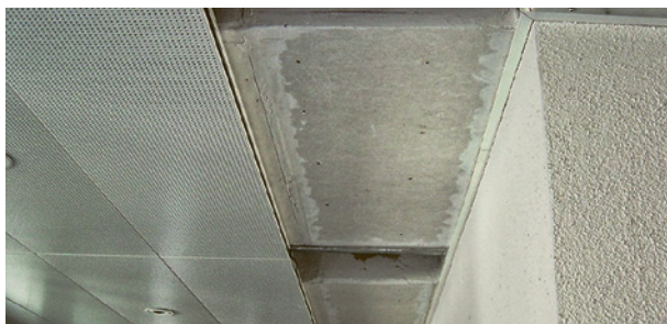
Pannelli per soffitti contenenti amianto
