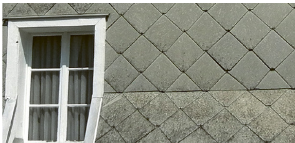
Pannelli per facciate contenenti amianto
