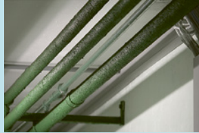
Vernici contenenti amianto
