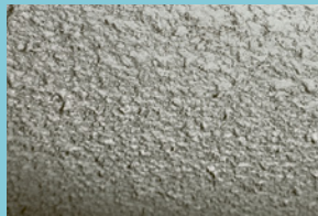
Intonaco contenente amianto
