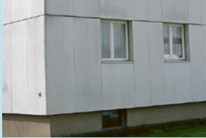
Pannelli per facciate contenenti amianto
