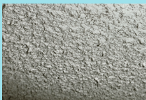
Intonaco contenente amianto
