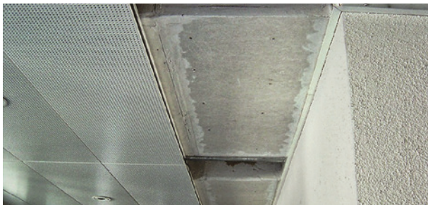
Pannelli per soffitti contenenti amianto
