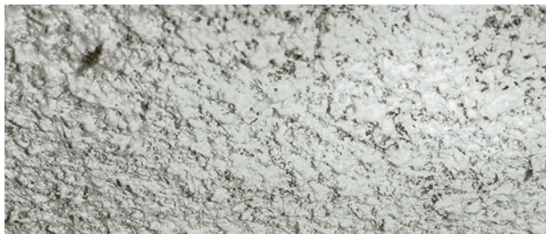
Intonaco acustico contenente amianto
