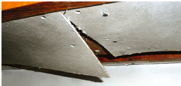
Pannelli leggeri contenenti amianto
